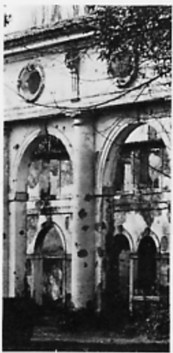
Scorcio delle barchesse deteriorate.
