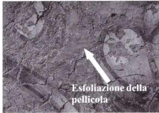
Fig. 38. Particolare delle campiture azzurre applicate al di sopra di una stesura a calce [cfr. Appendice a colori , Fig. 18 p. 203].
