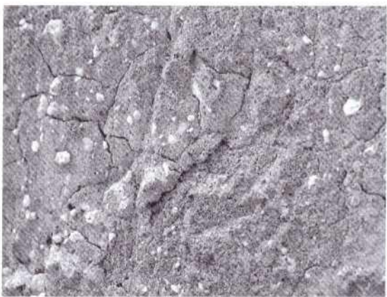
Fig. 17. Ca' Salvini, fessurazione e soluzione di continuità tra gli strati di intonaco.
