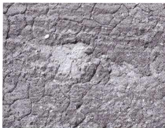
Fig. 18. Ca' Salvini, disgregazione localizzata.
