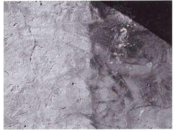
Fig. 20. Ca' Salvini, presenza di solfatazione e dilatamento delle superfici dipinte.
